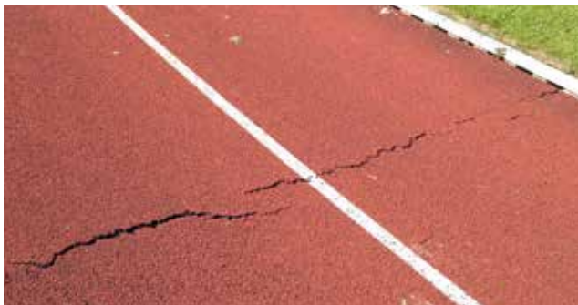
Deutlich erkennbare Risse
